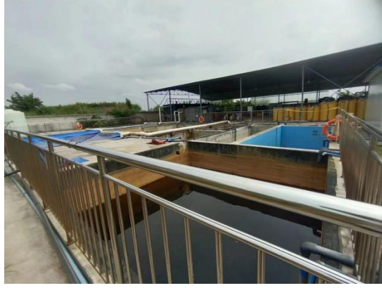
污水处理组合池
