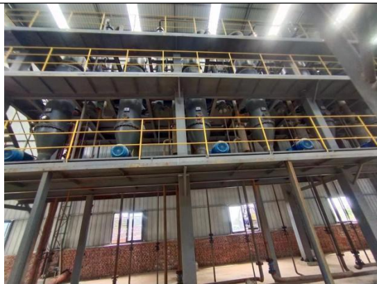
高效蒸发器设备
